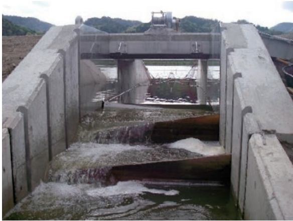
写真3 魚道機能を持った浮体式起伏ゲート
